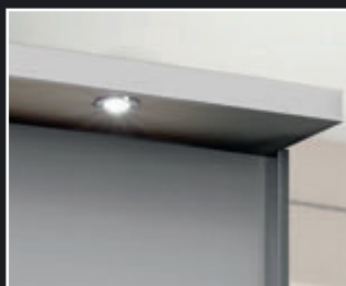
Kranzleiste mit LED-Spots Cornice with LED lights
